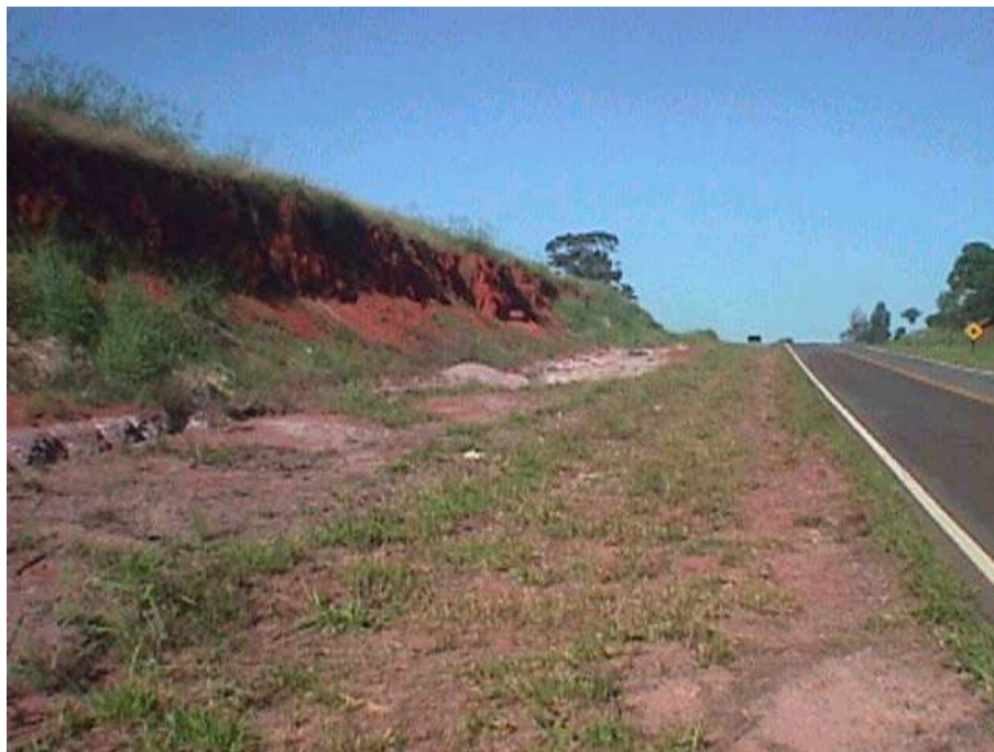
7. Barranco de estrada Rio Claro/ São Pedro - 2003
